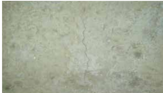
Probeta sin fibra DRYMIX RC 4020: CON RAJADURAS
